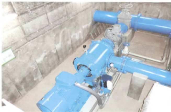
Turbina Francis (transmisión por poleas), de 95 kW operando con 48 m y 0,25 m 3 /s en estación de bombeo.
