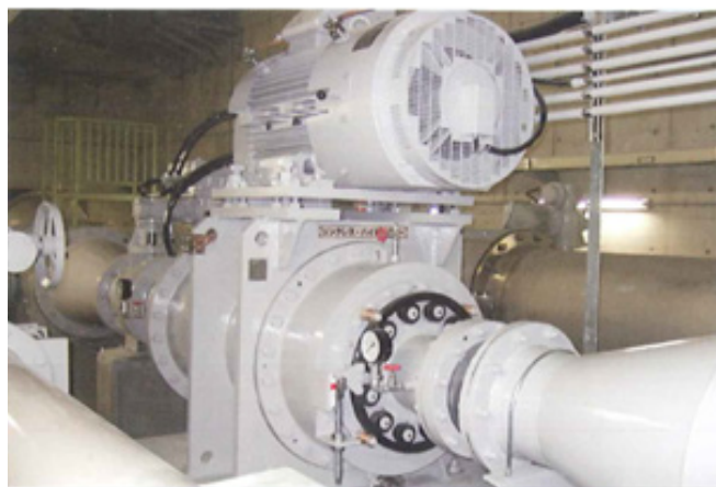
Turbina Francis (transmisión directa), de 32 kW operando con 14 m y 0,30 m 3 /s bajo embalse de agua de distribución.
